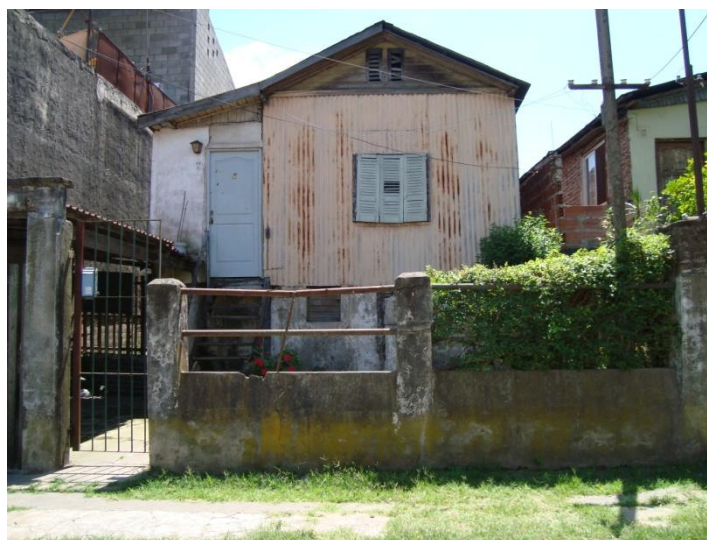
Foto 18: San Fernando, vivienda particular con signos de inundación, zona ribera (sobre calle Escalada y Quirno Costa). © IIED-AL (29-11-11)
